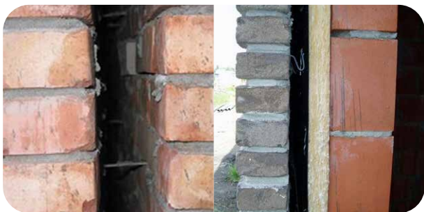
Spouwmuur zonder isolatie
